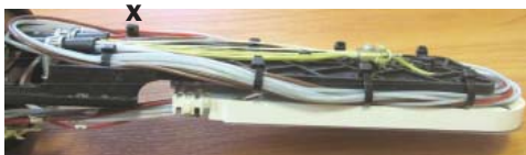
X – место фиксации «транзитных» петель ОМ на металлическом кронштейне
